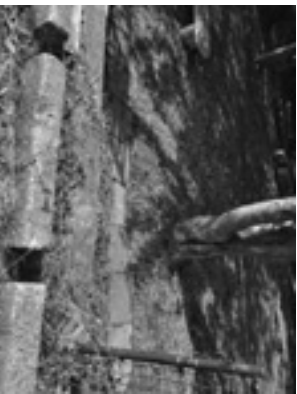
写真2：隣の公園との境界部分（崖）
