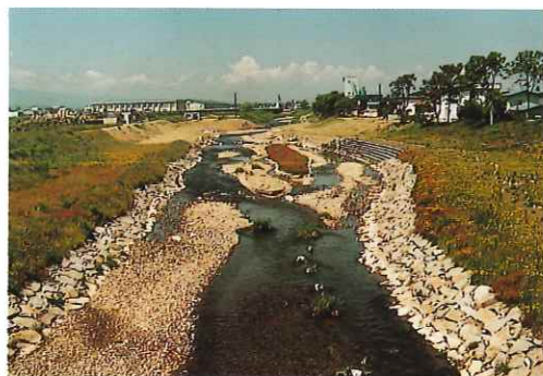
■ 自然石の採用により、周辺景観との調和が図られている
