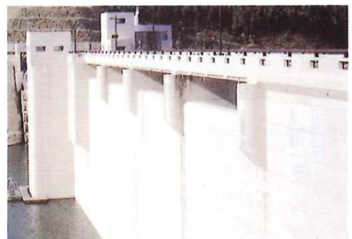
■ダム本体や高欄、照明施設についてデザインの工夫をしている
