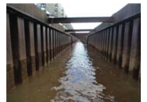
鋼矢板の腐食が進行している排水路
