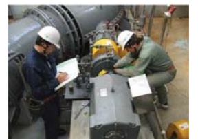
老朽化したポンプの機能診断
