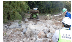
▲令和元年東日本台風 災害対応道路啓開作業状況(宮城県・丸森町)
