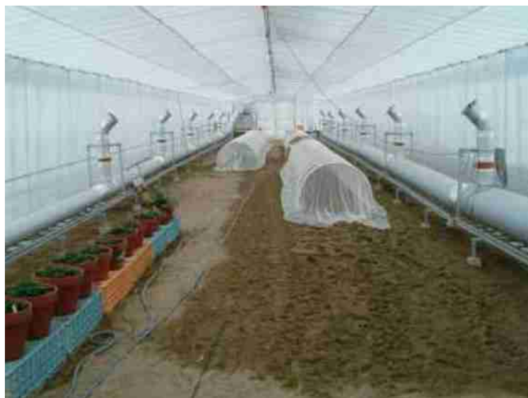
図 1.4.3.1 地中熱利用システムによるハウス栽培状況
