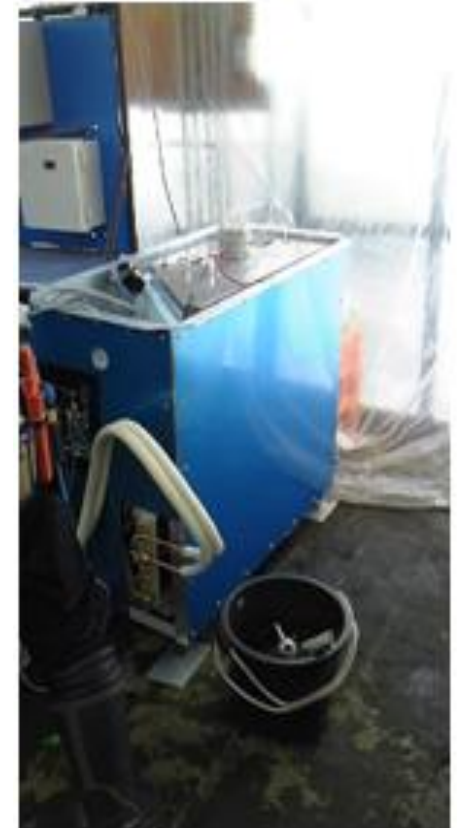
地中熱交換タンク
