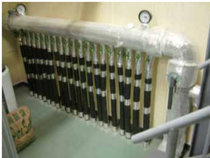
写真4 地中熱交換井循環用ヘッダー
