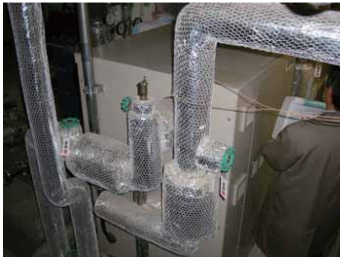
写真3 地中熱利用ヒートポンプ(空調用ビルマル)
