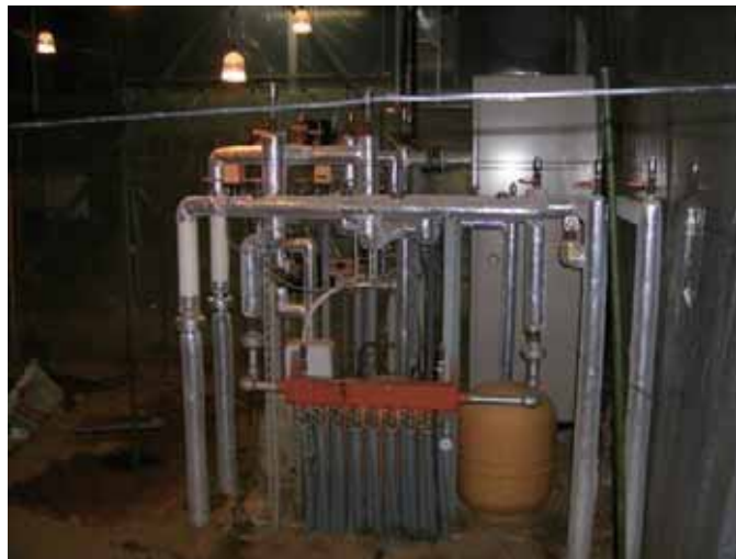
写真2 神内ファーム地中熱利用ヒートポンプ・暖房用配管
