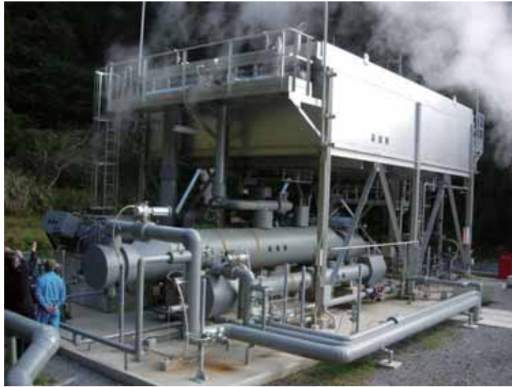
霧島国際ホテル実証試験設備（富士電機製）
