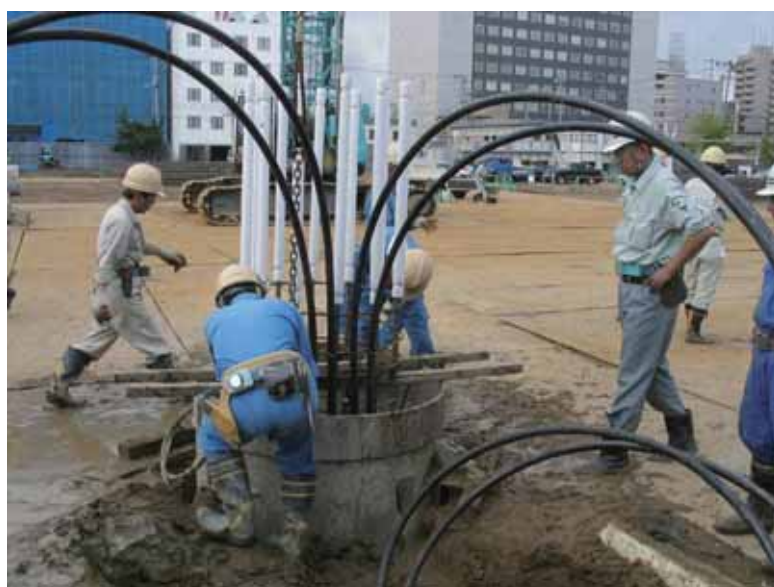
図 2-10 秋田市立山王中学校における基礎杭への熱交換器設置状況
