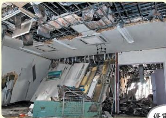
地 つなみ しんや津波のひ害を受けた仙 せんだい 台火力発電所
