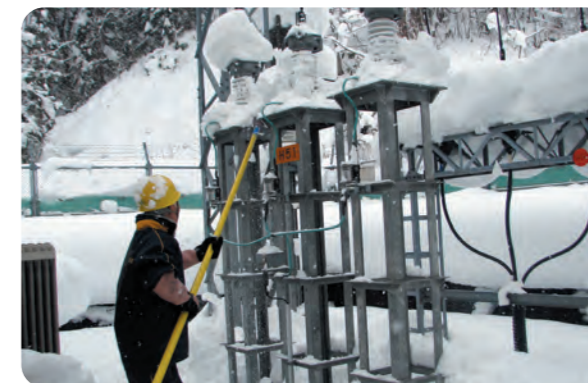
変電設備の上に積もっている雪を片付けている様子
