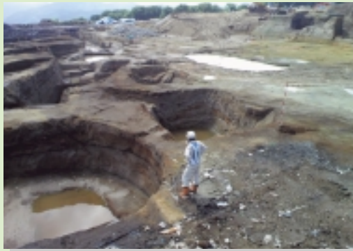
廃棄物の撤去を進めていくうちに、元々の地面の一部に穴を掘り廃棄物が捨てられていることがわかりました。
