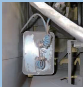
電気溶接機の内部に取り付けられた 低圧コンデンサー
