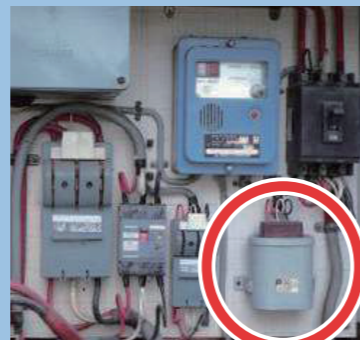
低圧分電盤内の 低圧コンデンサー
