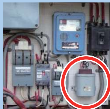
低圧分電盤内の 低圧コンデンサー
