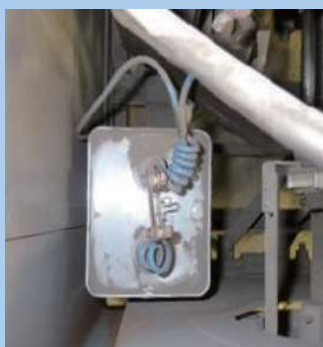
電気溶接機の内部に取り付けられた 低圧コンデンサー
