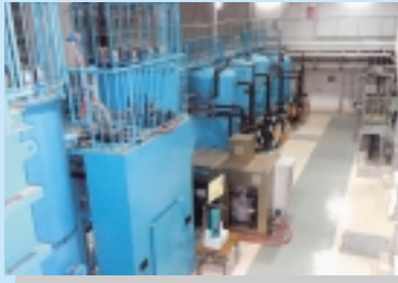
浸出水処理施設内部
