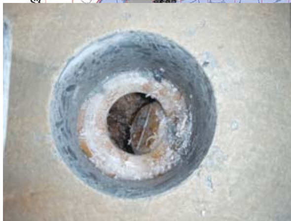
酸性の液体が混じったコンクリート塊
