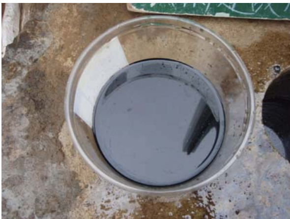
コンクリート塊に入っていた黒色液体
