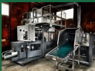
破碎と溶融固化を行う機器
