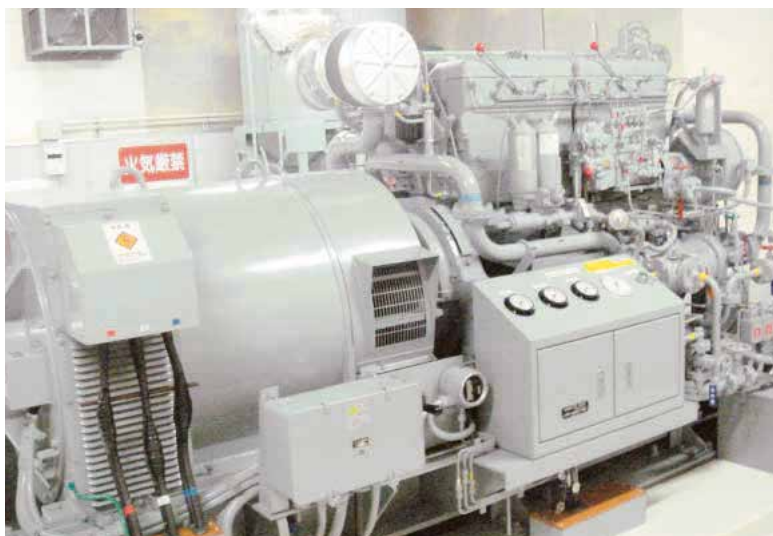
無線施設用発電装置 (国管理)
