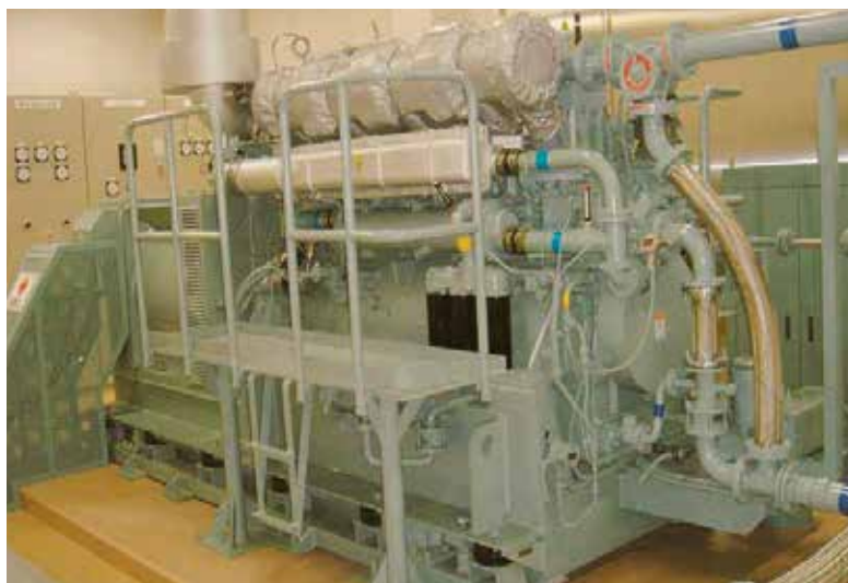
航空灯火用発電装置 (県管理)
