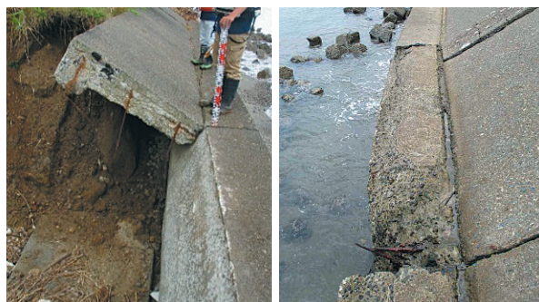
護岸背後の空洞化
