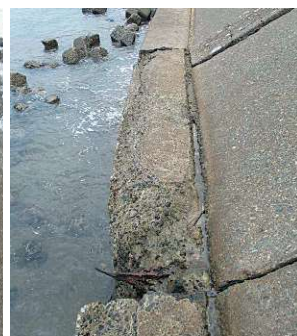
コンクリート表面の剥離
