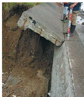
護岸背後の空洞化
