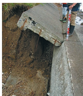
護岸背後の空洞化
