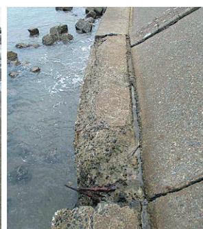
コンクリート表面の剥離
