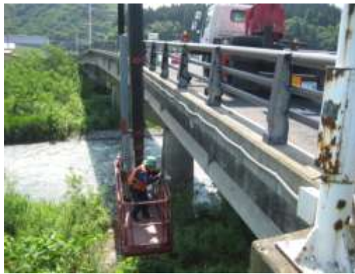
松代町陸奥赤石停車場線 開源橋（アルカリ骨材反応の追跡調査）
