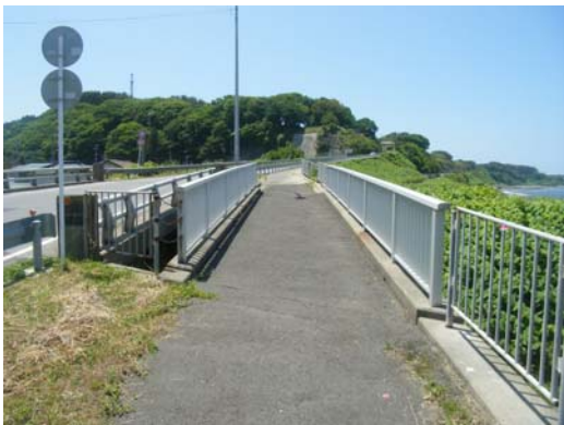
国道101号 新広戸橋側道橋【補修前】
