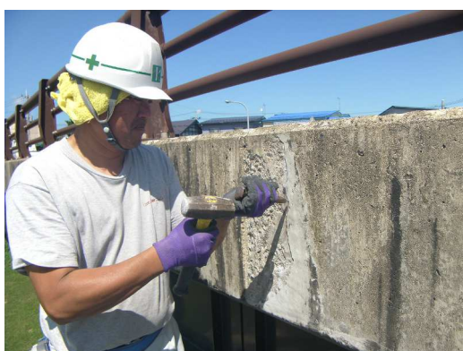
中南地域整備部緊急措置（叩落し）
