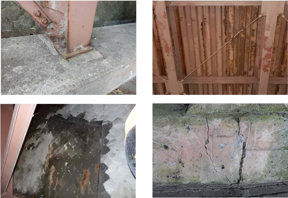
図-7 損傷状況の一例
