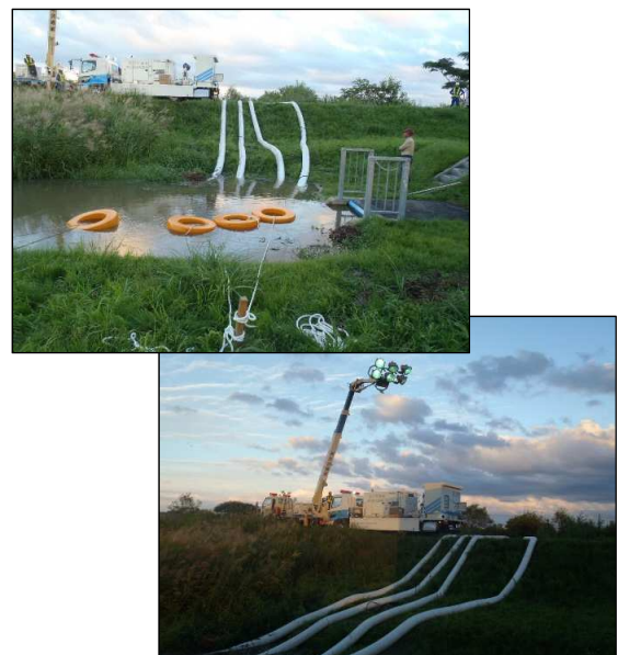
赤川破堤時の排水活動（東北町 H28 台風9号）
