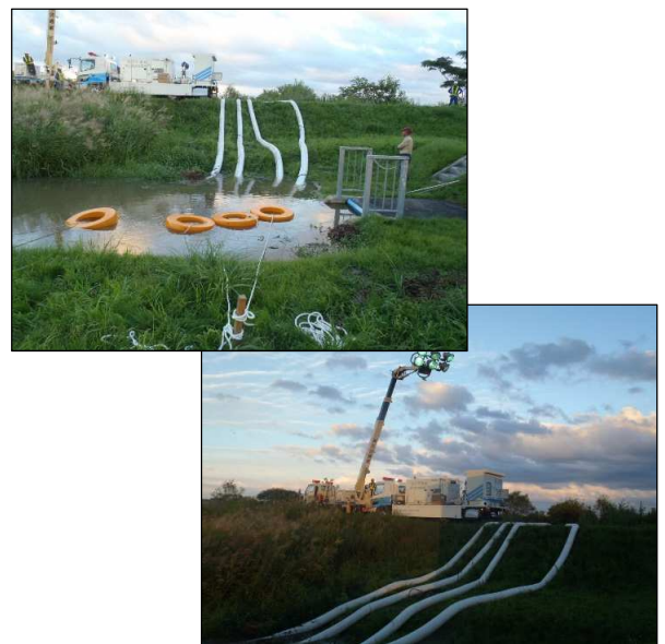
赤川破堤時の排水活動（東北町 H28 台風9号）
