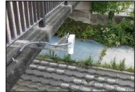
水位計の整備、改良
