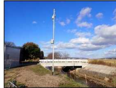
河川監視カメラの整備、改良
