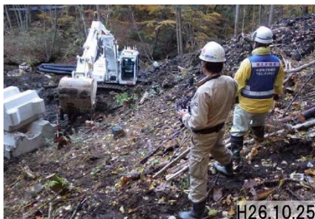
図 4.2.2 遠隔操作バックホウによる無人化施工（御嶽山 2014 年（平成 26 年）噴火時 鹿ノ瀬川）
