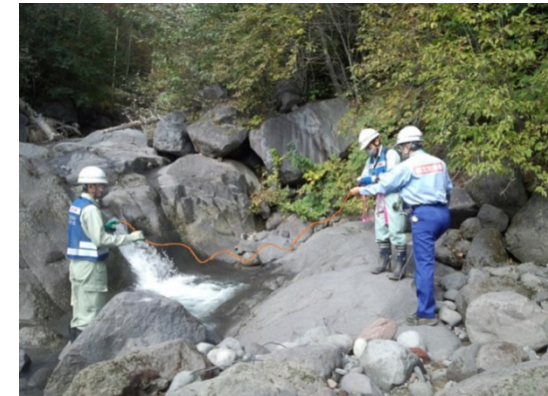
(2014年御嶽山噴火直後のワイヤセンサ緊急設置状況：中部地方整備局HPより)
