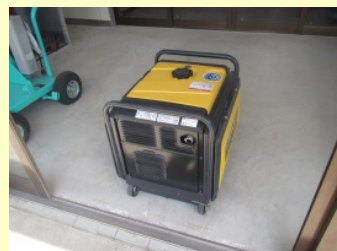
設置した発電機
