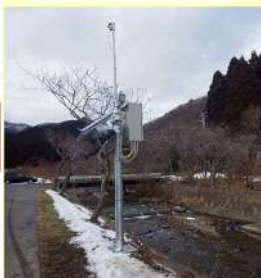
簡易型河川監視用カメラ設置例
