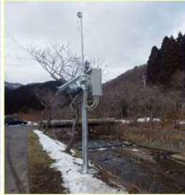
簡易型河川監視用カメラ設置例
