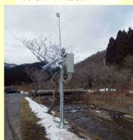
簡易型河川監視用カメラ
