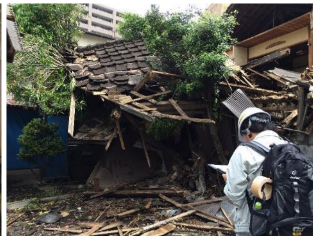
被災建築物応急危険度判定 (熊本地震)
