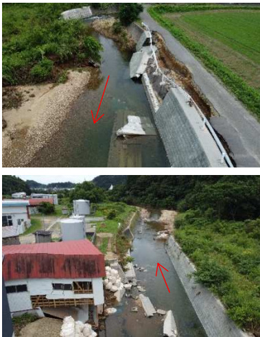
被災状況写真
