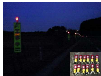
夜間事故防止の電光装置設置状況 (NETIS)
