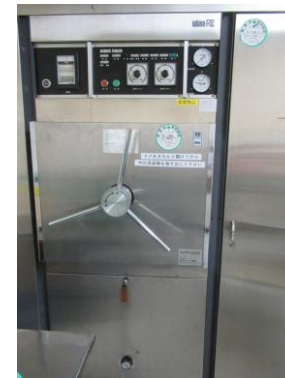
【蒸気滅菌装置】
