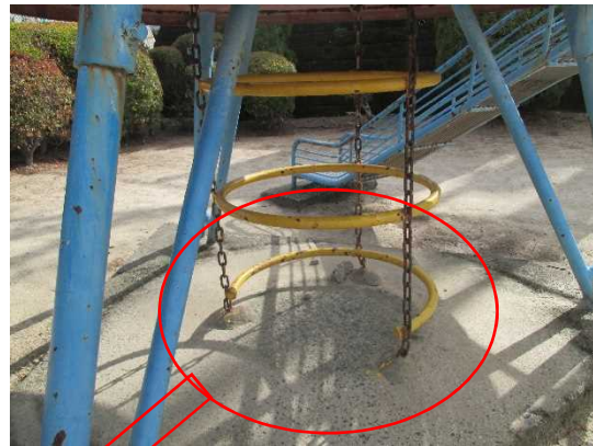
コンクリートの露出状況
