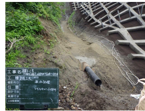
湧水箇所の応急処理
