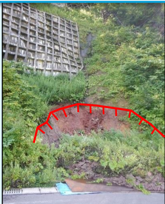
斜面崩壊発生！
