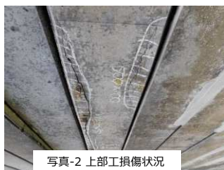
写真-2 上部工損傷状況
