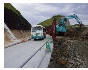
パネル式防護柵
