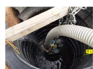
簡易集水柵内水中ポンプ
