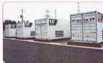
大容量電源装置 □ 配備台数/4台 (出力1台:2000kVA)
