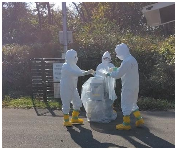
【可搬型モニタリングポスト設置】
