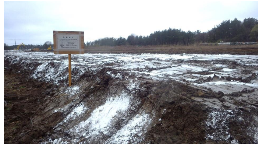
④0415 10時頃_ (1例目) 覆土・消石灰散布の終了、 発掘禁止看板の設置
