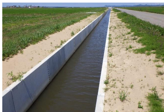
基幹水利施設ストックマネジメント事業 (車力排水路地区 つがる市 R3～R6)
