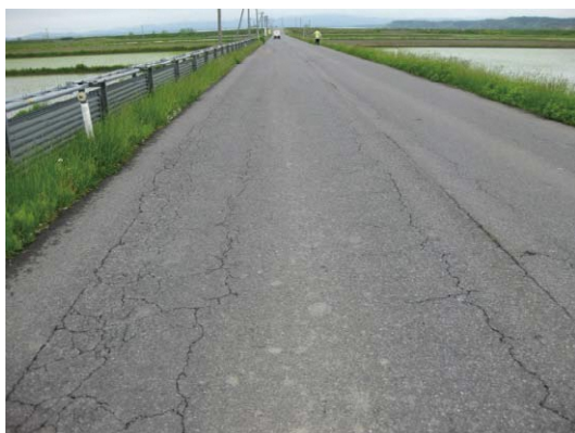
【保全対策前の農道】
