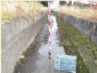
【水路表面の骨材露出】
