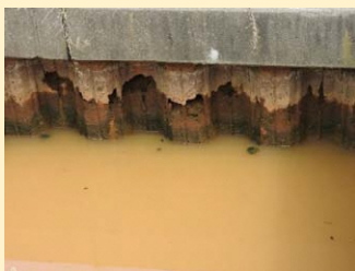
【軽量鋼矢板腐食】
