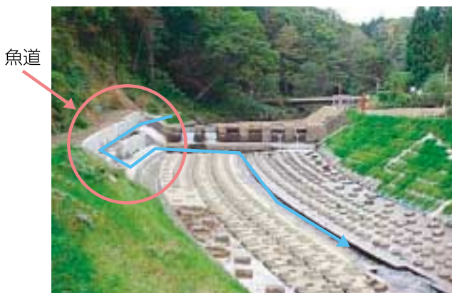
魚道が設置された頭首工(外ヶ浜町)
