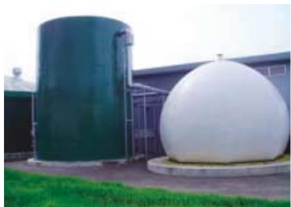
バイオガス発生プラント (野辺地町、畜産試験場)
