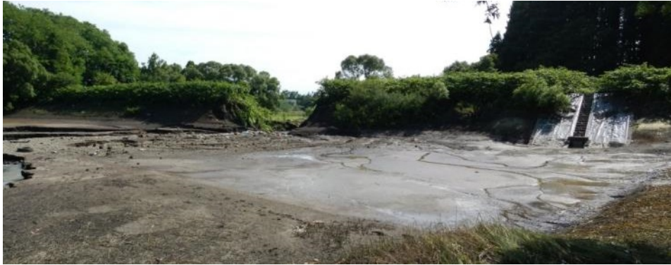
決壊したため池の状況
