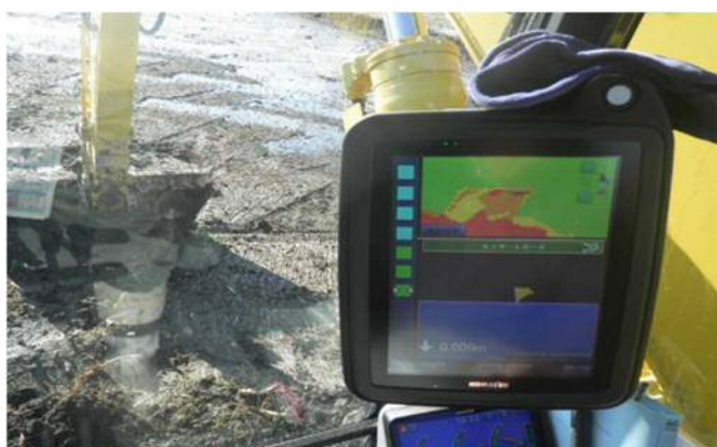
【機械内のモニター】
