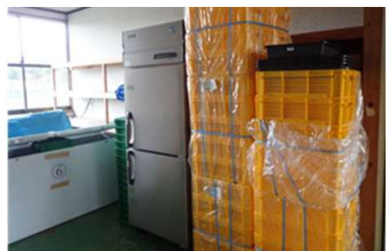
カシス冷凍設備（農業研修センター）
